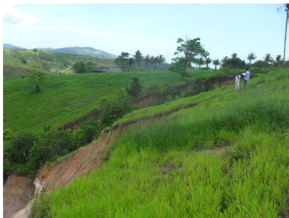
Foto 4: Área Crítica 1 – Posto Bem V – erosão.
