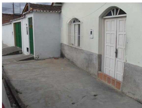
Foto 10: Área Crítica 5 – Rua Frei Geraldo – área de alagamento.
