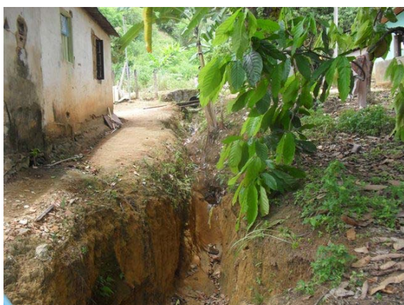
Foto 29: Área Crítica 18 – Rua Grêmio – área de erosão.
