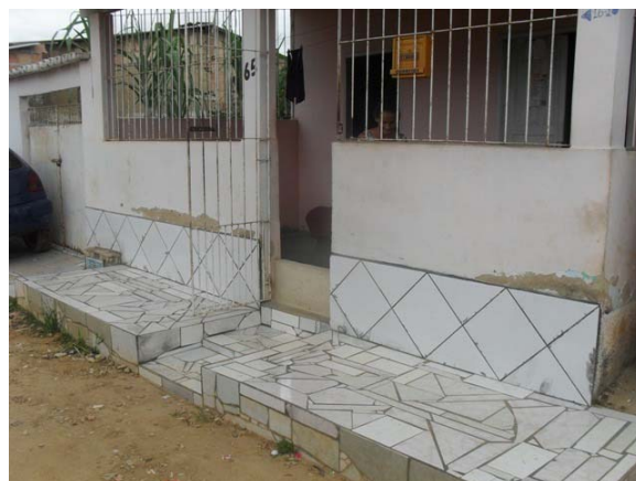
Foto 20: Área Crítica 12 – Rua Bahia – área de alagamento.
