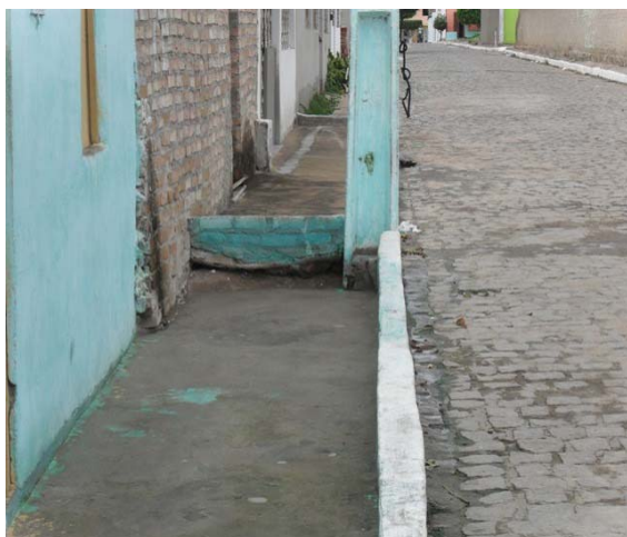
Foto 9: Área de alagamento. Rua com as casas de nível mais baixo.
