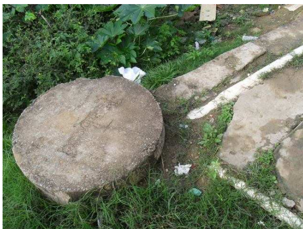
Foto 9: Rede de esgotamento construída pela EMBASA, utilizada pela população.
