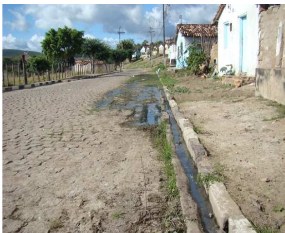
Foto 9: Esgoto a céu aberto – Rua Francisco Leal Sales.
