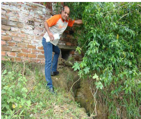
Foto 3: Condomínio Cância de Andrade – lançamento de esgoto misto no fundo da casa da Sra. Rosenilda Santos Andrade.
