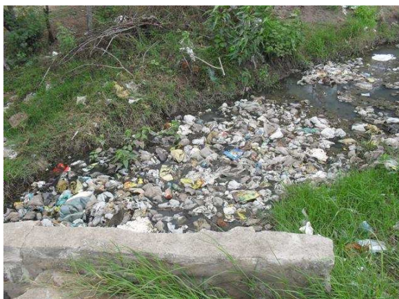
Foto 9: Av. Irmã Dulce, bueiro com lançamento a céu aberto. Detalhe: presença de lixo.
