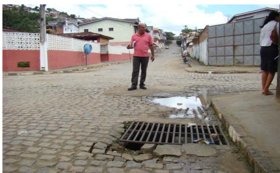
Foto 5: Entroncamento das redes de drenagem – Rua Dr. Alberto Mato com a Rua Professora Maria da Glória.
