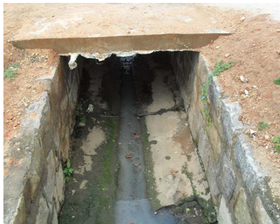
Foto 10: Trecho do canal aberto de alvenaria de pedra. Apresenta esgoto secundário. Próximo da Rua da Estação.
