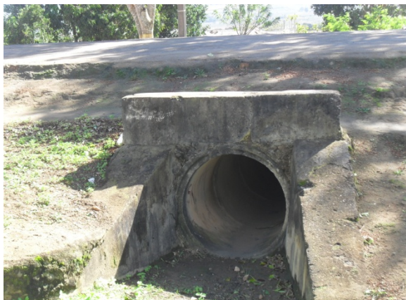
Foto 1: Bueiro sub Av. Aurélio Assis de oliveira. Escoamento de águas pluviais.
