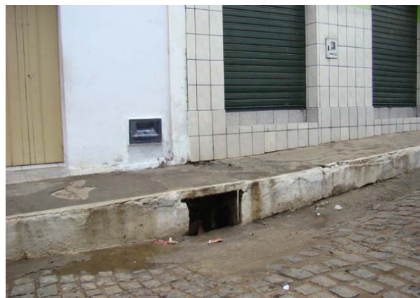
Foto 6: Boca de Lobo do sistema de microdrenagem – Rua Salvador Vaz.
