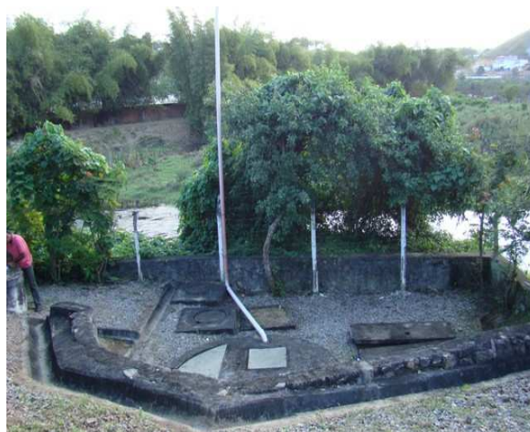
Foto 2: Estação Elevatória – Loteamento Beira Rio.
