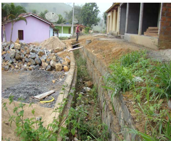
Foto 3: Ponto de lançamento da valeta de drenagem em manilha com diâmetro de 1000mm, iniciada na estrada da Pindoba, ao lado da Feira e o Mercado Municipal.
