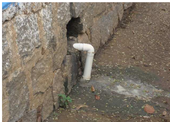
Foto 4: Ponto de lançamento detalhe da tubulação apresenta lançamentos difusos. Vai para o Riacho da Casa Forte.
