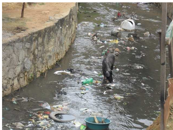
Foto 4: Rio Casca – conduto de esgoto e águas pluviais com presença de lixo.
