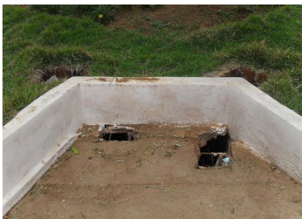
Foto 11: Ponto da chegada das águas pluviais, sistema de micro-drenagem.
