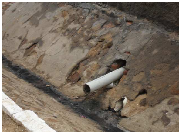
Foto 7: Canal a céu aberto, detalhe de tubulação jogando esgoto.
