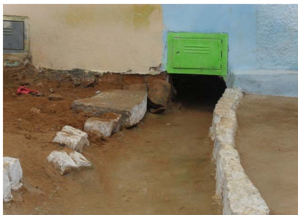
Foto 2: Caixa de chegada das águas pluviais. Próximo do Açude Municipal.
