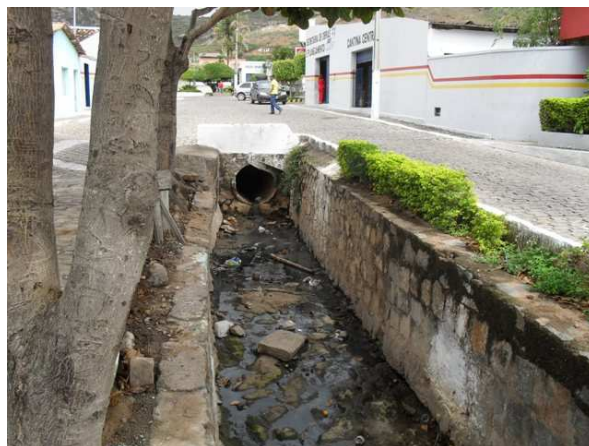
Foto 2: Canal de drenagem conduzindo esgoto.
