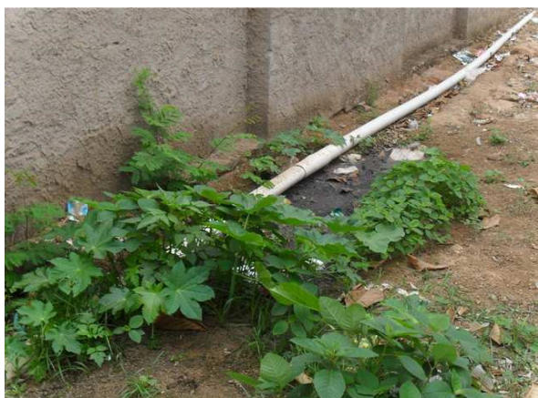
Foto 11: Lançamento de esgoto a céu aberto. Rua 2 de julho.
