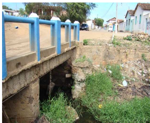
Foto 6: Ponto de lançamento de esgoto no Rio Casca – Praça do Axé.
