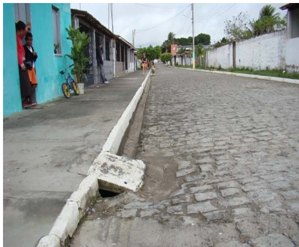
Foto 4: Rua São Paulo – Boca de Lobo – Área crítica.
