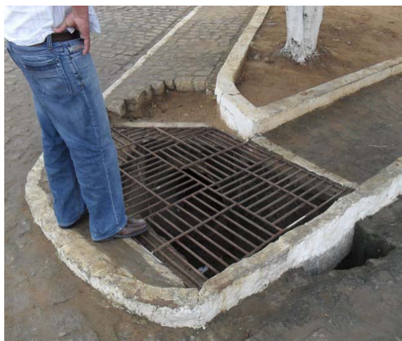
Foto 8: Caixa de passagem com grelha horizontal, Praça S. Antonio.
