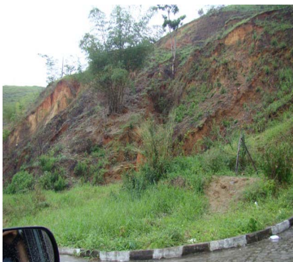
Foto 3: Erosão de talude na Praça São Roque.
