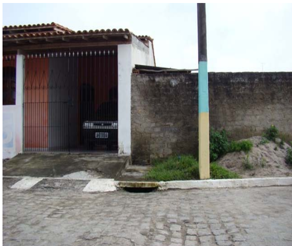
Foto 3: Rua São Paulo – Boca de Lobo – Área crítica.
