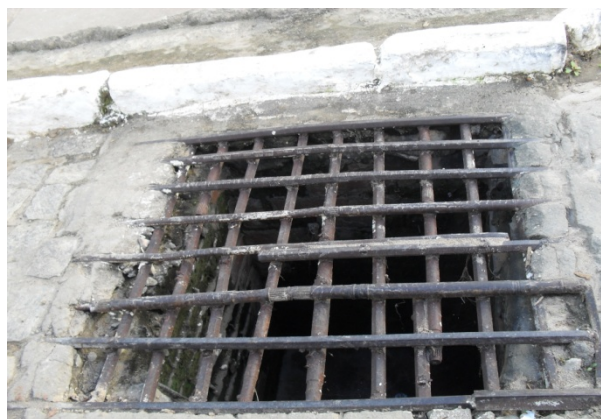
Foto 6: Sistema de macro-drenagem. Caixa de passagem com grelha horizontal.
