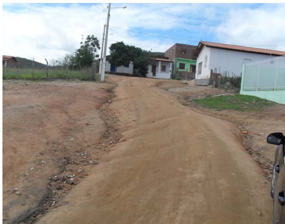
Foto 2: Rua não pavimentada com declividade acentuada, canal natural de escoamento de água.
