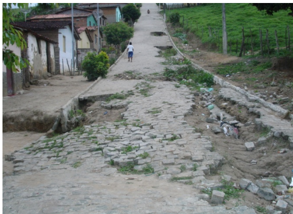
Foto 1: Rua Adolfo Elias, (final da Rua). Processo de erosão bastante acentuado.
