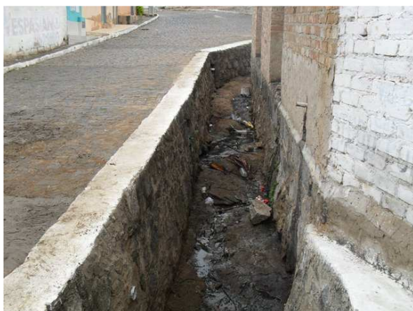
Foto 3: Canal de drenagem com presença de esgoto
