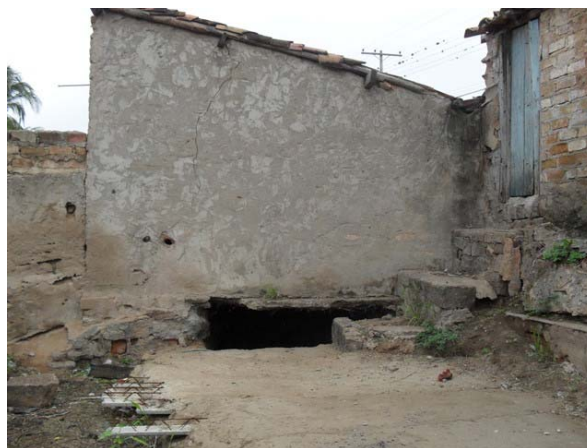
Foto 10: Galeria de drenagem com construções irregulares.
