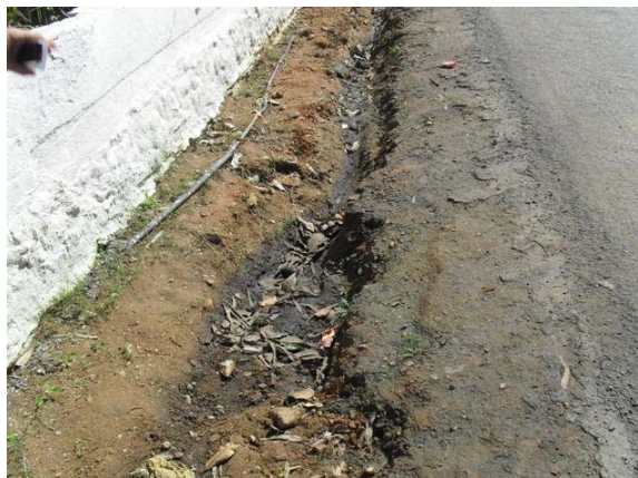
Foto 2: Av. Sabatino Di Girolamo - área de erosão.
