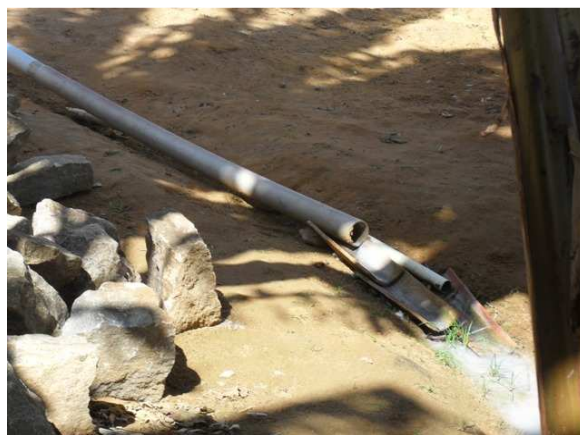
Foto 4: Lançamento de esgoto a céu aberto.
