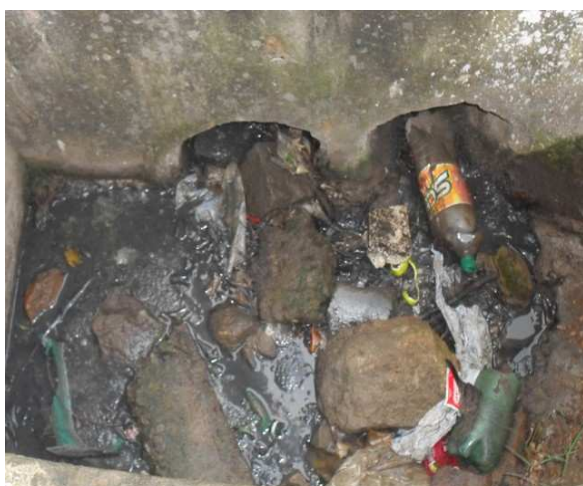
Foto 3: Caixa de chegada do esgoto.
