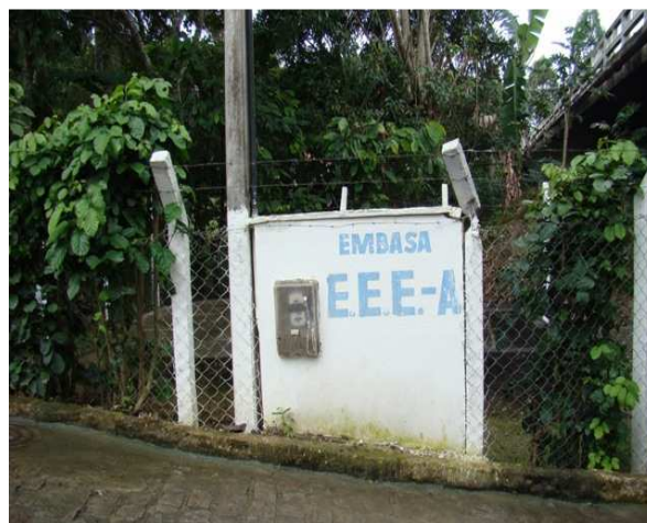
Foto 4: Estação Elevatória de Esgoto “A” – embaixo da ponte da BR-420 – saída para Ubaíra.
