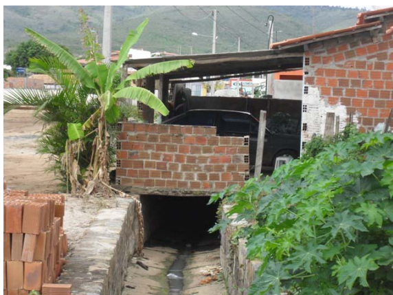
Foto 11: Canal aberto de alvenaria de pedra, Próximo da BA-493. Apresenta esgoto secundário. Passa por baixo de residência construída indevidamente.
