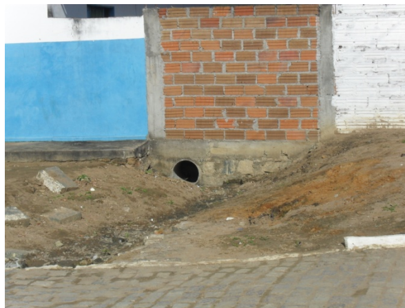
Foto 2: Rua Padre Anchieta, manilha de diâmetro 40 mm, escoamento de água de uso.
