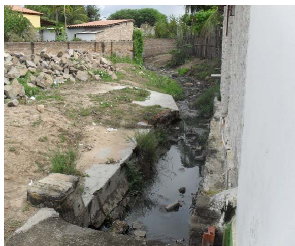
Foto 4: Rua da Torre. Lançamento de Águas Pluviais e esgoto a céu aberto.
