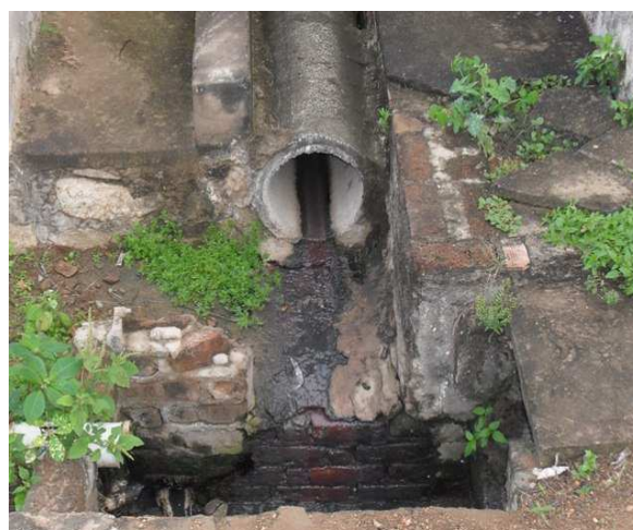
Foto 4: Caixa de passagem do esgoto.
