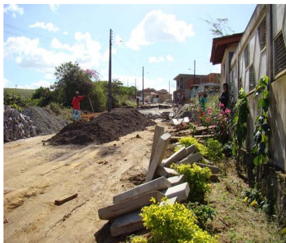
Foto 10: Obra de pavimentação, sem drenagem na Rua Carlos Lanza – Bairro Alto da Jaqueira.
