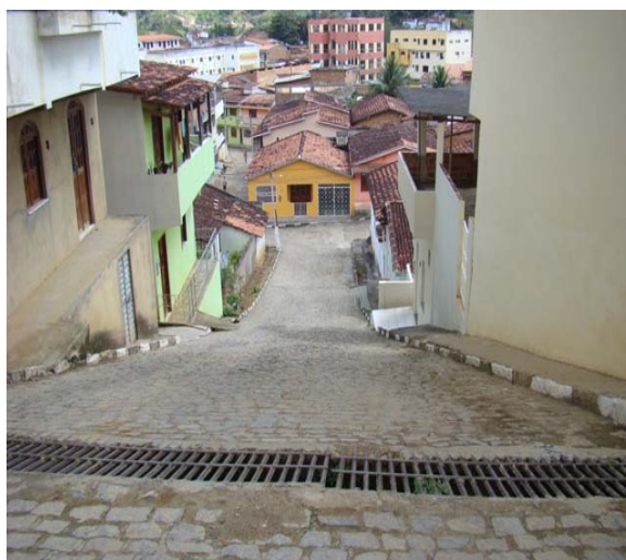
Foto 4: Calha na Rua José Pedro de Souza. Diâmetro de 300 mm.
