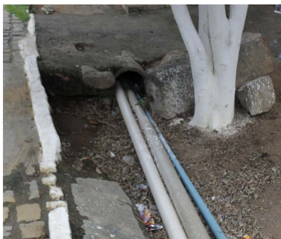
Foto 10: Área de alagamento sistema misto. Praça Santo Antonio.
