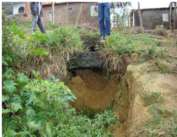
Foto 2: Erosão próxima a Rua José Gomes Aragão.
