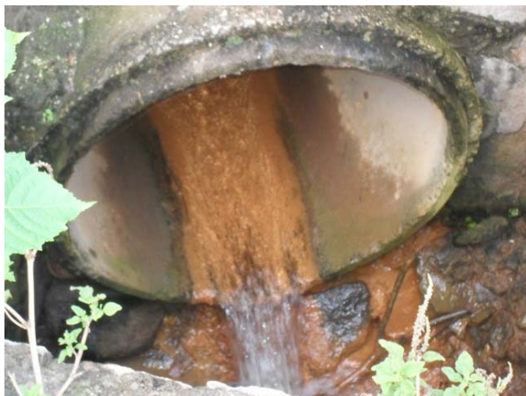
Foto 9: Lançamento de água pluvial no rio
