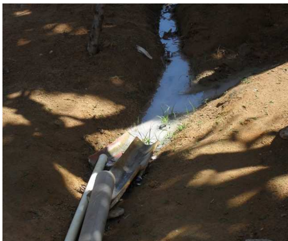
Foto 5: Lançamento do esgoto a céu aberto.
