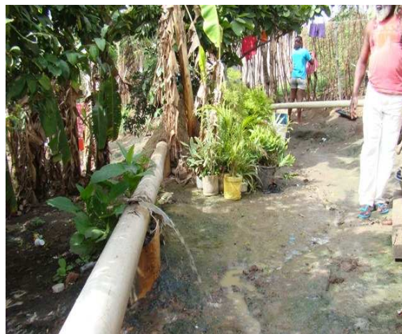
Foto 2: Rede de esgoto aparente – tubo Ø150 vazando no terreno de Dona Marinalva Augusta de Jesus – Rua C.
