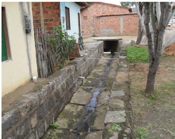
Foto 9: Canal aberto de alvenaria de pedra próximo das casas residenciais.
