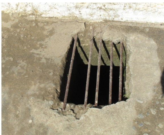
Foto 3: Sistema de macro-drenagem com grelha horizontal.
