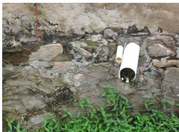
Foto 6: Tubulação de esgoto lançamento do fundo da residência.
