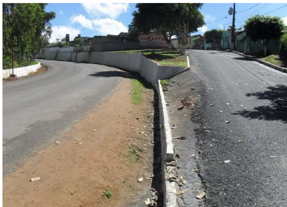
Foto 3: Ponto de lançamento de esgoto próximo da rodovia mercado.
