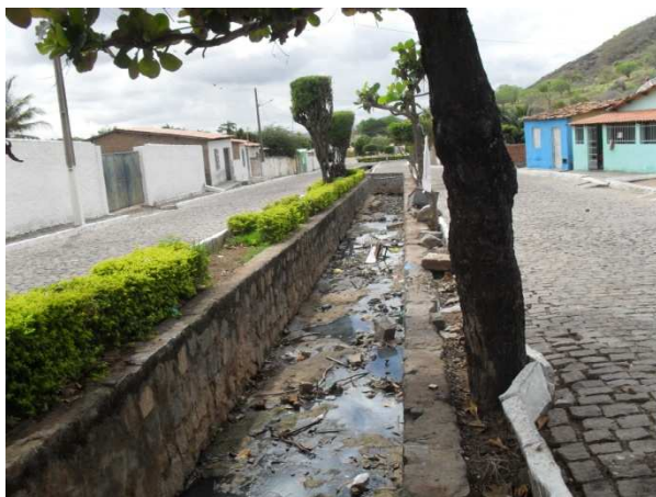
Foto 1: Canal de drenagem conduzindo esgoto.
