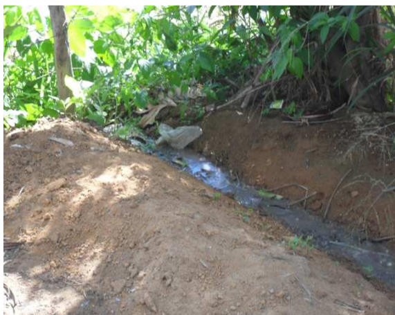
Foto 3: Lançamento do esgoto a céu aberto.
