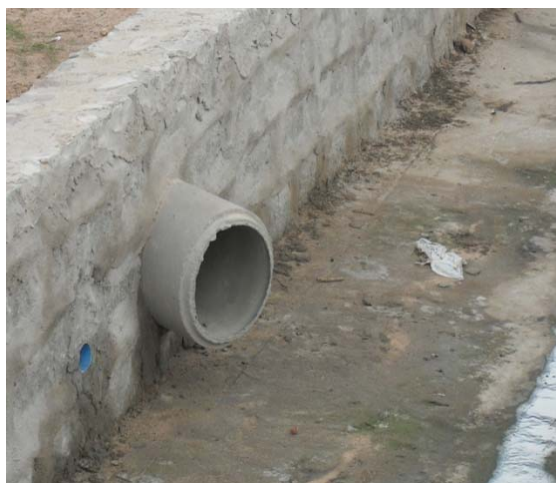
Foto 10: Ponto de lançamento de águas pluviais e esgoto. Manilha de diâmetro Ø100 mm.
