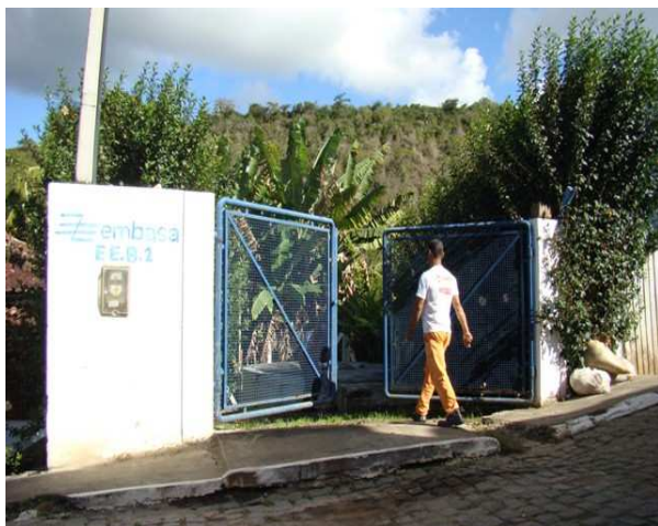
Foto 1: Estação Elevatória B – Rua Baixa da Monta – final da Rua 9 – reclamação de mau cheiro.
