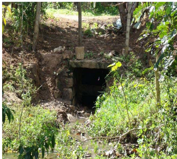
Foto 2: Galeria de drenagem – lançando no Rio Jiquiriçá.
