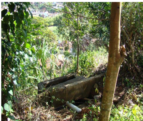
Foto 9: Ponto de lançamento de drenagem das Ruas Itapetinga e Dom Macedo.
