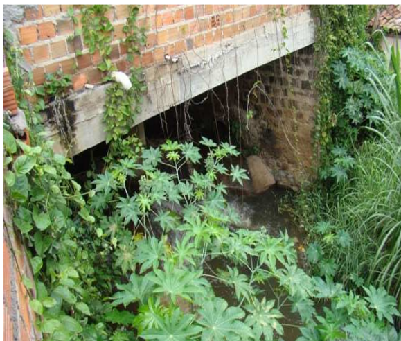
Foto 3: Pontos de lançamento de esgoto na rede de drenagem.
