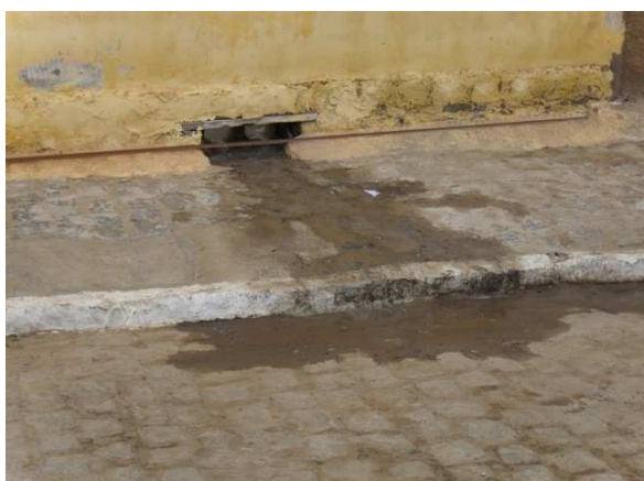
Foto 3: Ponto de lançamento de esgoto, próximo da Praça da Bandeira.
