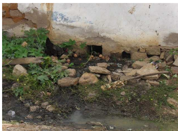
Foto 4: Ponto de lançamento de esgoto, próximo Rua 2 de julho entre a Travessa da Vitória.
