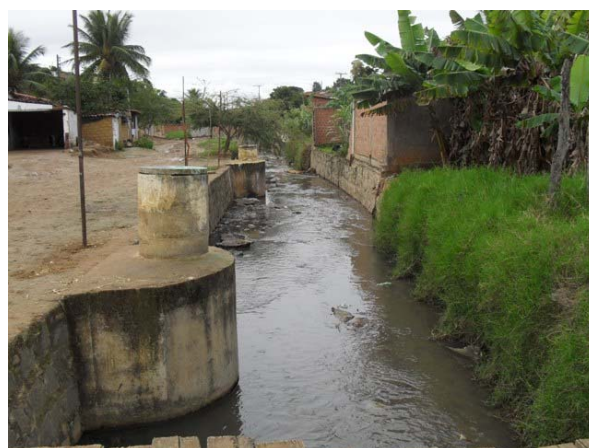
Foto 12: Rede de PV'S do interceptor de esgotos.
