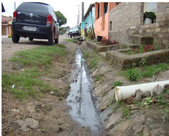
Foto 1: Condomínio Cância de Andrade – esgoto a céu aberto.
