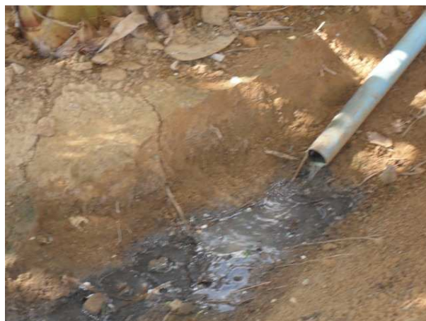
Foto 2: Lançamento do esgoto a céu aberto.
