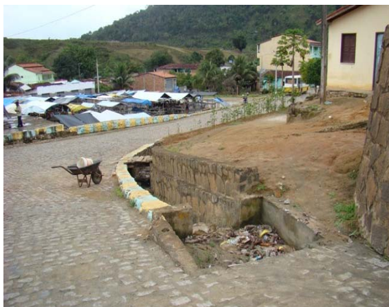
Foto 1: Valeta de drenagem - no início da estrada da Pindoba, ao lado da Feira e o Mercado Municipal.
