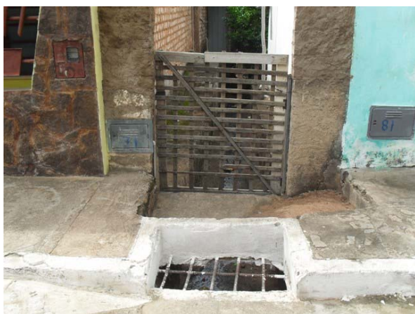
Foto 5: Drenagem entre os lotes e caixa com grelha
