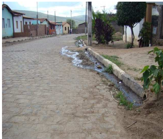
Foto 8: Esgoto a céu aberto na Rua Francisco Leal Sales.
