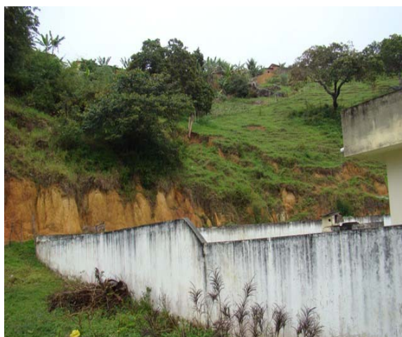
Foto 4: Erosão atrás do Fórum, na Rua Carneiro da Rocha, com projeto de engenharia aprovado e em licitação (solo grampeado).
