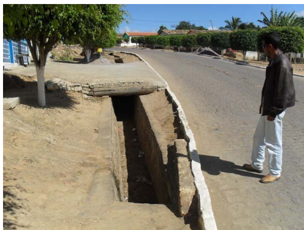
Foto 4: Rodovia para Maracás, sistema de macrodrenagem.
