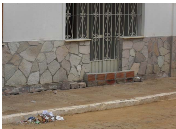
Foto 12: Fachada da residência com uma pequena estrutura para evitar escoamento de água para dentro de casa. Próximo da Praça da Bandeira.
