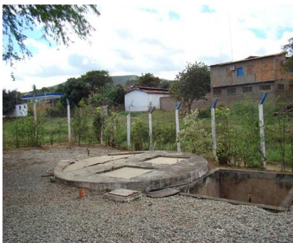
Foto 11: Estação Elevatória 2 – Rua marechal Deodoro – reclamação de mau cheiro.
