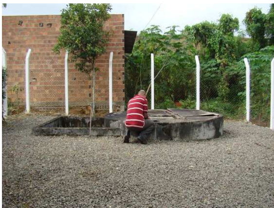
Foto 1: Estação Elevatória “B” – Rua 2 de Julho, com muitas reclamações de mau cheiro.
