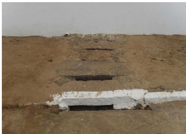
Foto 4: Boca de Lobo, sistema de micro-drenagem. Próximo da Praça Principal.
