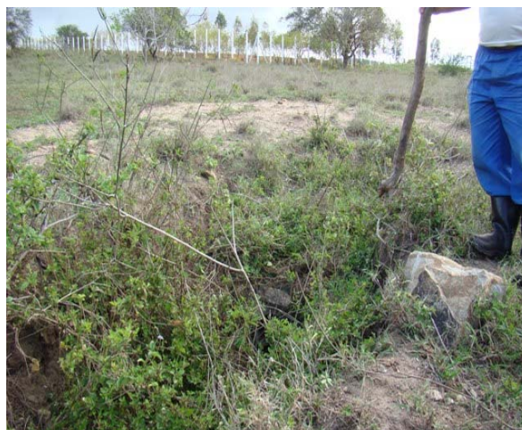
Foto 4: Fim da rede de drenagem.
