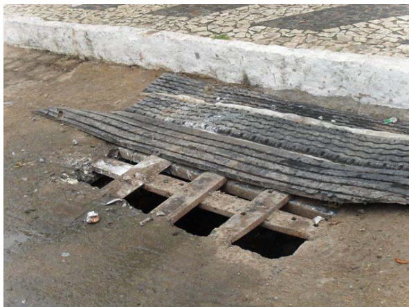
Foto 1: Caixa com grelha – obstruída pela população.
