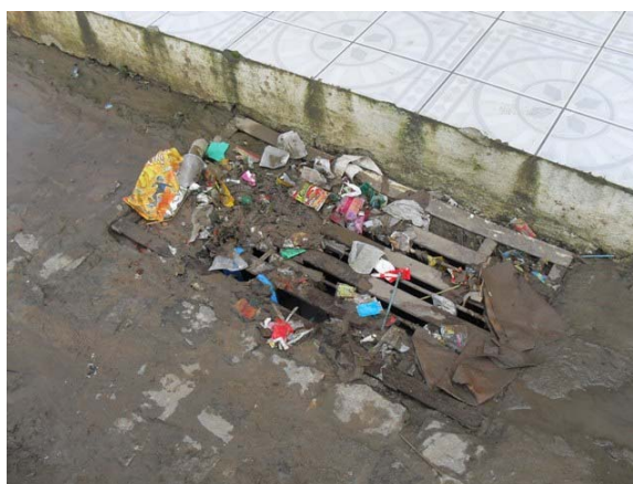
Foto 6: Ponto de alagamento, caixa coletora com grelha
