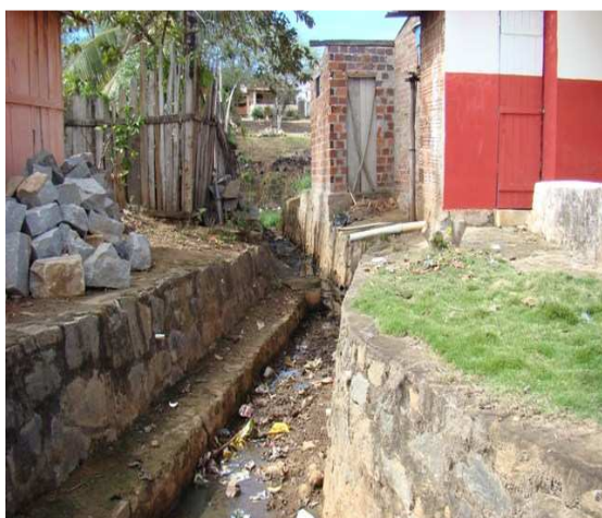
Foto 5: Estrutura de lançamento de esgoto e águas pluviais – Rua Tiradentes.
