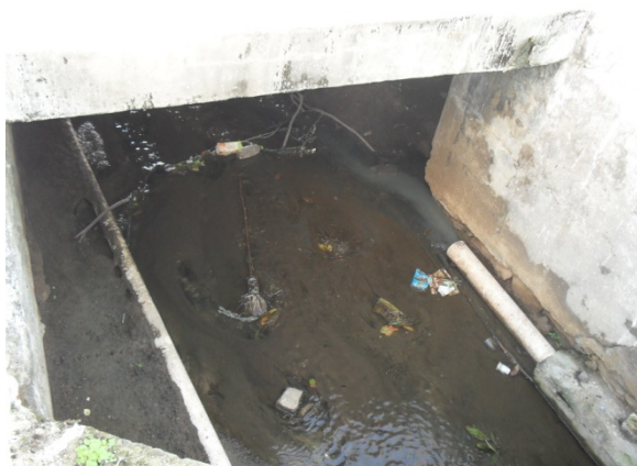
Foto 7: Boqueirão escoamento de águas pluviais e esgoto secundário que vai para o Riacho de Floresta.
