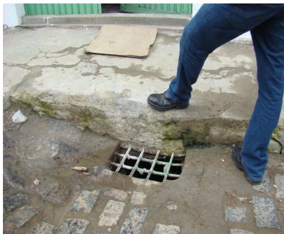
Foto 7: Caixa coletora na Rua Salvador Vaz.
