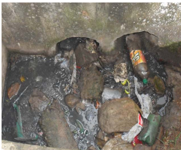
Foto 11: Caixa de chegada sistema de micro-drenagem de águas pluviais e esgoto secundário. Próximo da BR-116.
