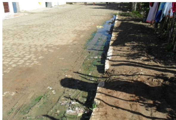
Foto 6: Área de alagamento de águas pluviais.
