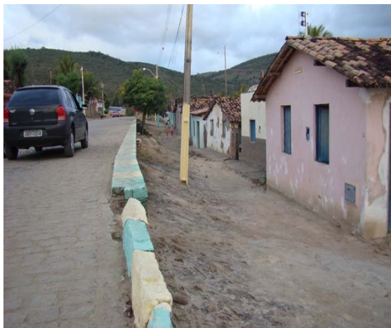
Foto 1: Casas abaixo do nível da Rua Alcides José de Souza.
