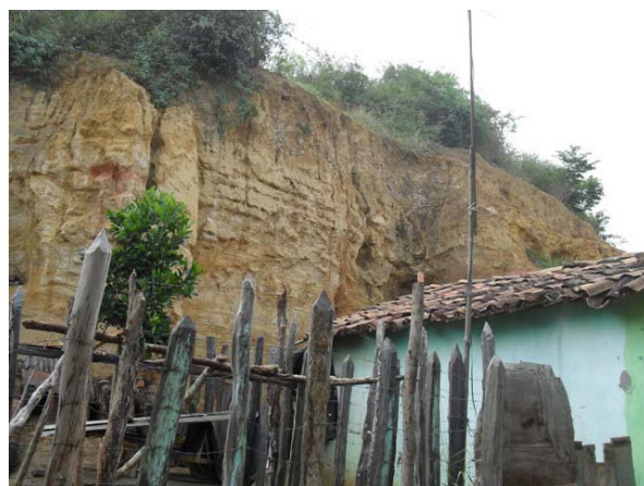
Foto 4: Encosta com risco de desabamento.
