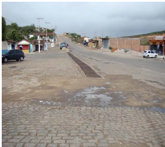
Foto 2: Grelha de recolhimento de águas pluviais para estrutura de macrodrenagem na Praça da Estação.
