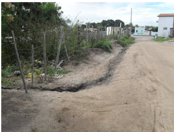
Foto 1: Ponto de Lançamento de esgoto a céu aberto.
