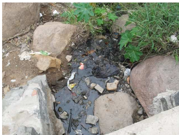
Foto 6: Esgoto lançado a céu aberto.
