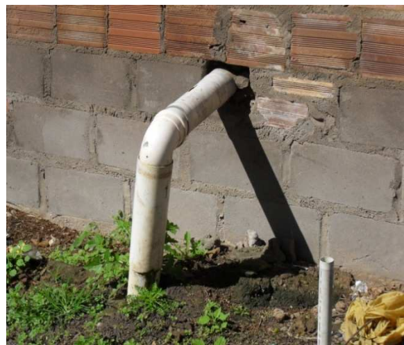
Foto 2: Tubulação lança esgoto para fossa no fundo da residência.
