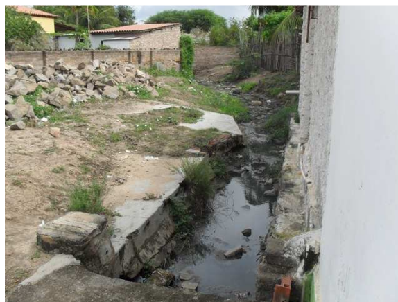
Foto 4: Canaleta sistema de micro-drenagem. Com lançamento a céu aberto. Próximo da Ferrovia.
