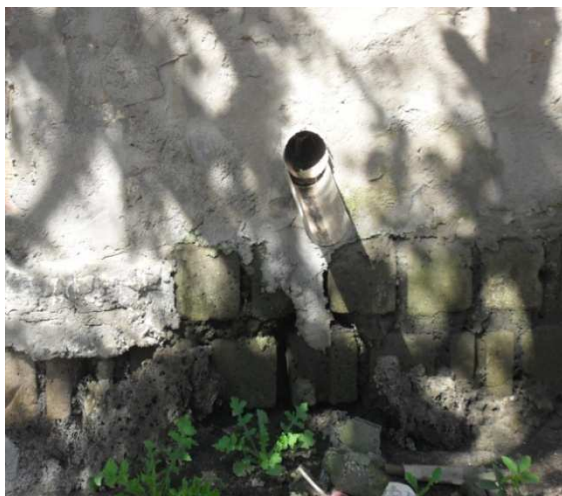
Foto 1: Saída do esgoto do funda da residência com lançamento a céu aberto.
