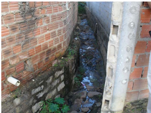
Foto 1: Trecho revestido – construções irregulares sobre as paredes.
