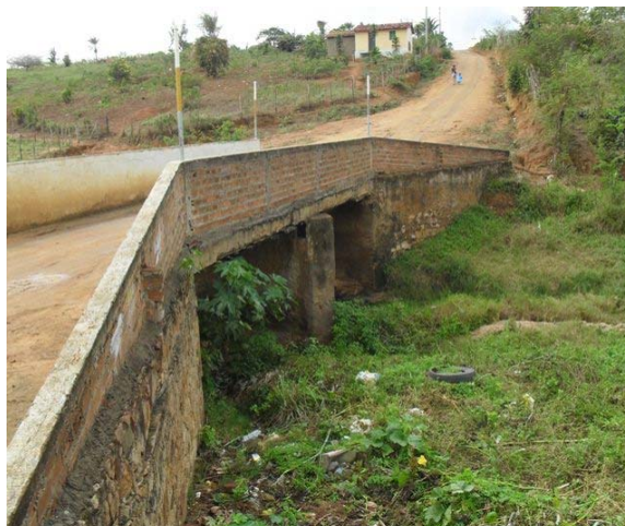
Foto 2: Ponte sub o Rio Jiquiriçá. Ponto de escoamento das águas.
