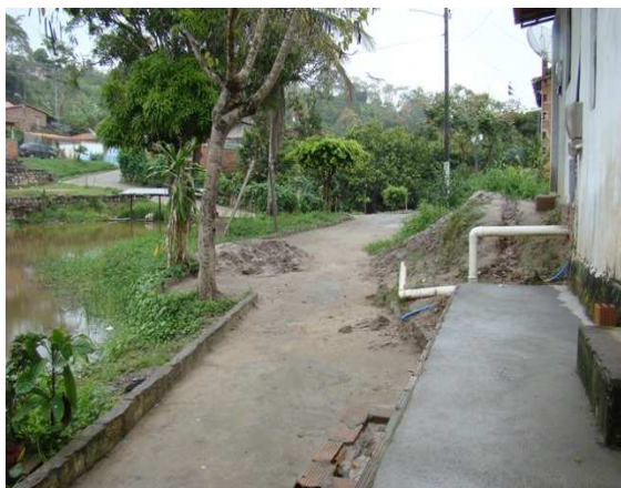
Foto 1: Lançamento direto de esgoto no Rio Ronco - Travessa Getúlio Vargas.
