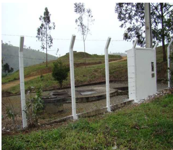
Foto 9: Estação Elevatória "C" – Rua Coronel Vicente – atrás do hospital.
