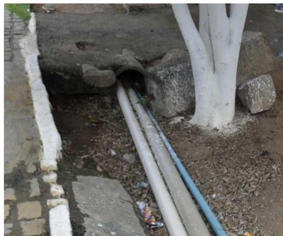
Foto 2: Tubulação de água e esgoto sistema misto.
