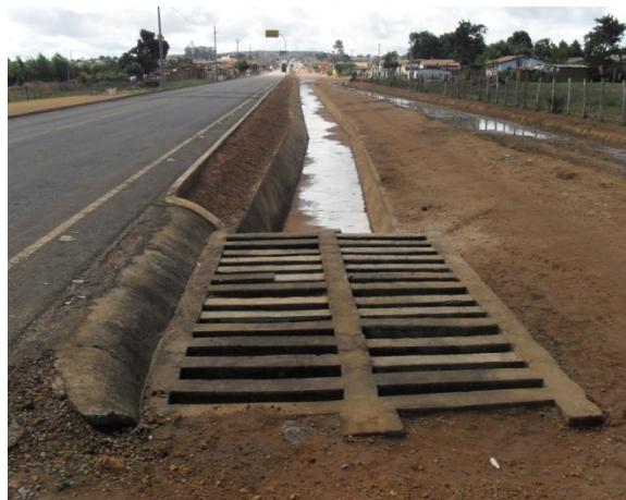
Foto 4: Canal aberto ao longo da BA-026. Caixa de chegada com Grelha horizontal.
