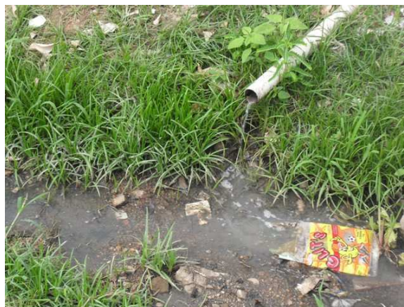
Foto 2: Lançamento de esgoto a céu aberto, seguindo para Lagoa da Várzea.
