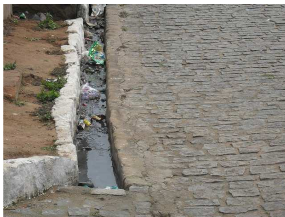
Foto 8: Valeta – drenagem, esgoto e lixo
