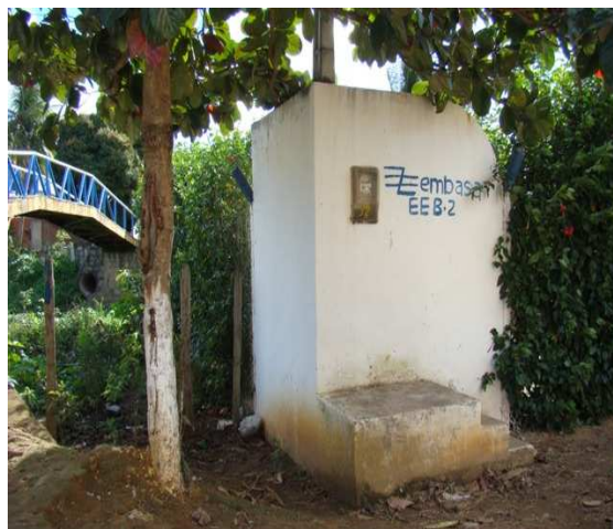
Foto 2: Estação Elevatória B – Rua Baixa da Monta – final da Rua 9 – reclamação de mau cheiro.
