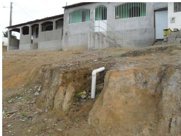
Foto 2: Lançamento de esgoto secundário a céu aberto.
