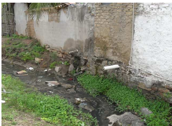
Foto 5: Canal natural com lançamento do esgoto a céu aberto. Tubulação no fundo lança esgoto no fundo das casas.
