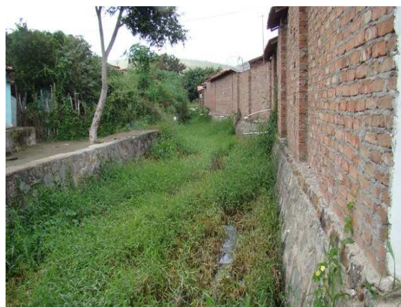
Foto 4: Trecho com lançamentos de esgoto no Rio Casca.
