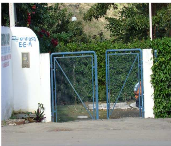
Foto 3: Estação Elevatória A – Rua do Hospital – entrada da cidade.
