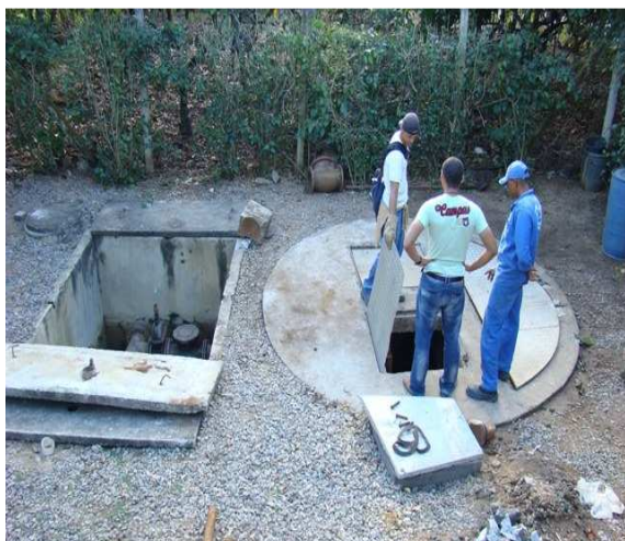
Foto 3: Estação Elevatória na Rua Bartolomeu Chaves.
