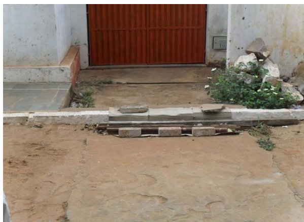
Foto 10: Área de alagamento da Rua da Praça da Bandeira.
