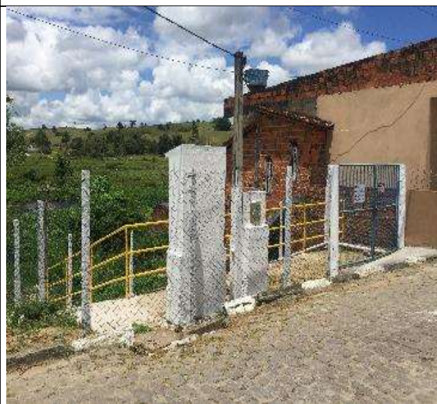
Figura 5.6 – EEE 01 do Sistema Sede (Laje).
