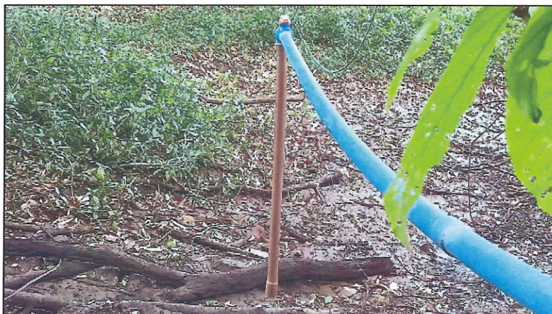
Figura 29 – Captação clandestina de água
