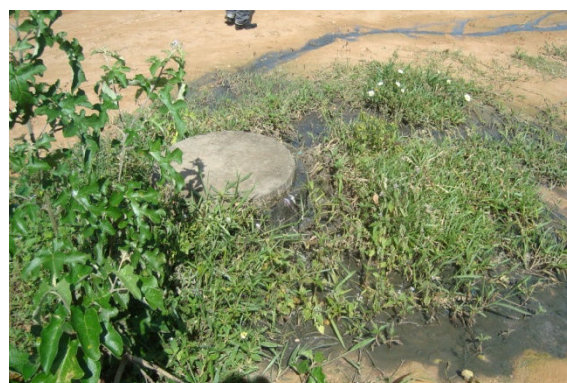
Figura 4.52 - Poço de Visita Transbordando, Esgoto a Céu Aberto – Jardim Campo Verde
