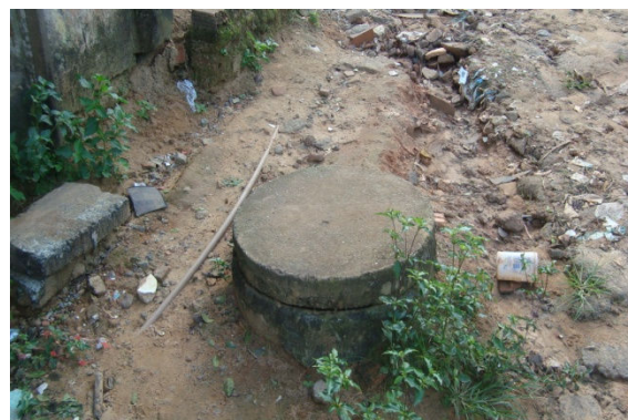
Figura 4.48 - Caixa de Passagem Próxima a Rede de Água Aflorando no Solo, Jardim Campo Verde
