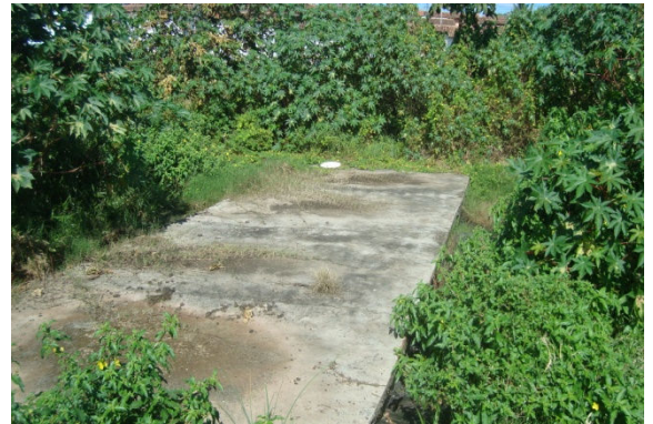
Figura 4.54 - Uma das Fossas Sépticas que Recebe o Esgoto Coletado do CH Jardim Campo Verde
