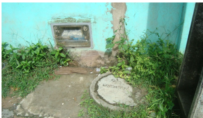
Figura 4.69 - Caixa de Passagem, Loteamento Vila Santana
