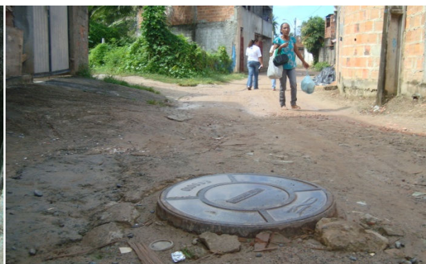
Figura 4.70 - Poço de Visita (PV), Loteamento Vila Santana
