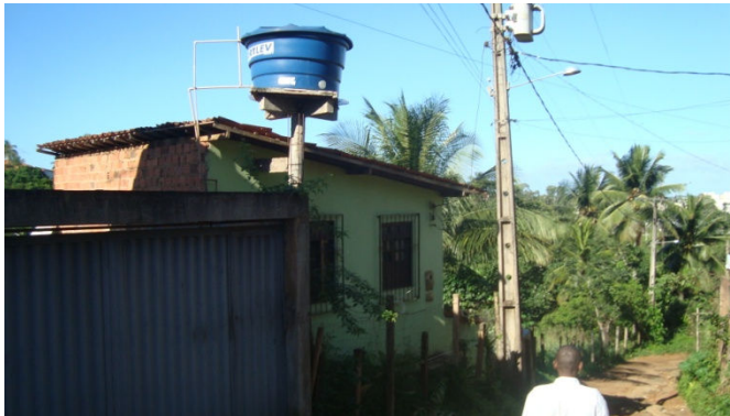
Figura 4.16 - Reservatório com Tampa, Comunidade Alto do Girassol
