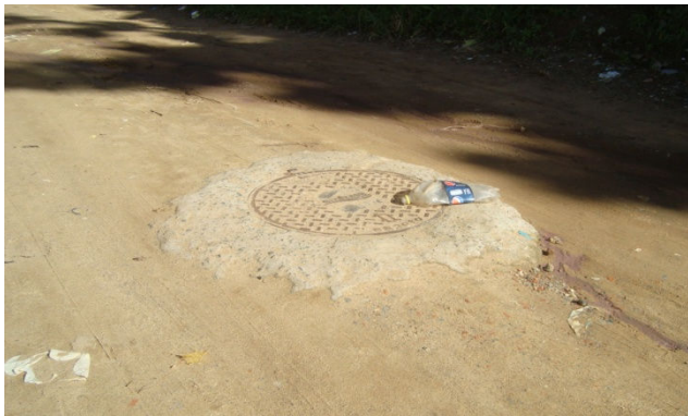
Figura 4.73 - Poço de Visita (PV), Alto do Girassol – Via Principal
