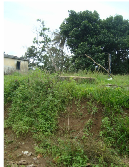
Figura 4.37 - Base do Reservatório de 2.000 L (RAD 1) – Comunidade Pedreira Carangi
