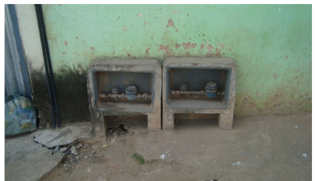
Figura 4.5 - Localidade Jardim Campo Verde/Barro Duro, Hidrômetros
