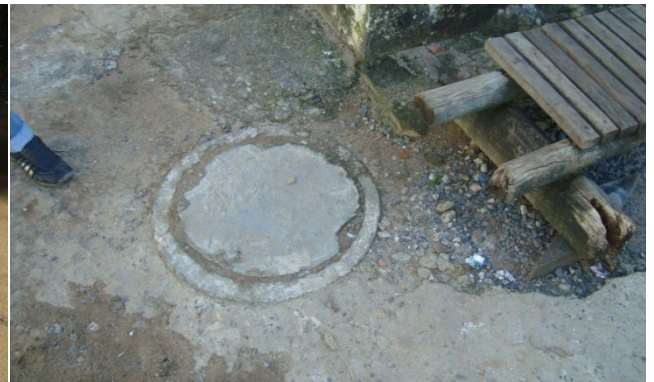
Figura 4.74 - Caixa de Passagem, Alto do Girassol
