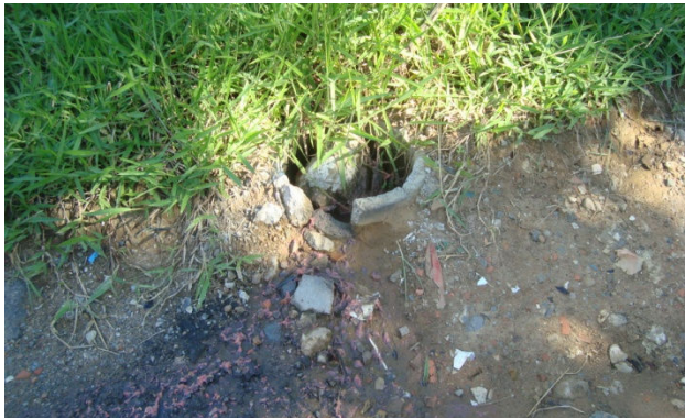
Figura 4.75 - Caixa de Passagem Danificada, Alto do Girassol
