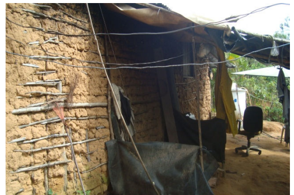
Figura 4.82 - Precariedade das Casas Existentes na Área de Carobeira "Buracão"
