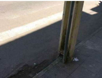
Foto 03- Mobiliário urbano mal posicionado nas calçadas existentes.
