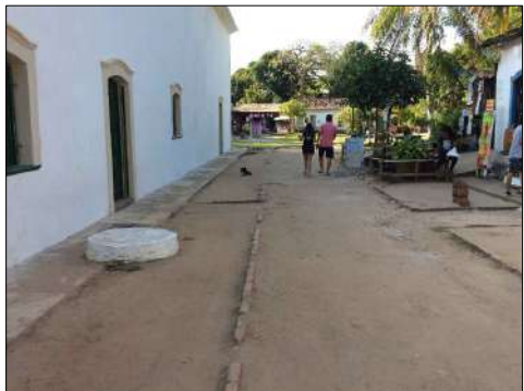
Foto 03 - Vista dos passeios existentes com o meio-fio em tijolos cerâmicos, incompleto.
