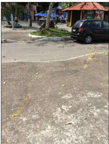
Foto 11 - rebaixamento de calçada existentes, sem indicações com piso podotátil ou pintura de faixa de travessia de pedestre.
