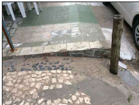
Foto 08 - Exemplo de desnivelamento existente nas calçadas da R. Direta de Jauá.
