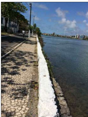
Foto 13 - Calçadas da Av. Dois de Julho, que margeia o rio, apresentando necessidade de instalação de guarda-corpo (ver DET-06-Guarda-corpo).
