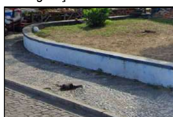
Foto 02 - Calçadas com pedra portuguesa com vários pontos com onde faltam pedras ou com crescimento de vegetação.
