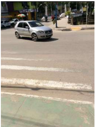
Foto 03- Faixas existentes em más condições.
