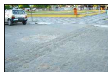
Foto 03 - Faixa de travessia de pedestre existente sem pintura adequada.
