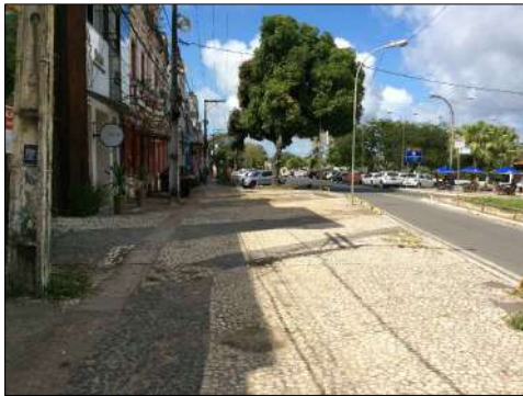
Foto 07 - Calçadas da Av. Dois de Julho. Necessidade de restauração, possibilitando a acessibilidade.
