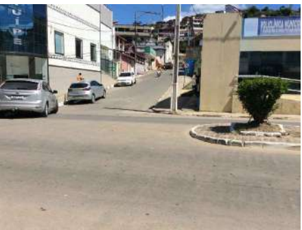
Foto 07- Falta de sinalizações horizontais.
