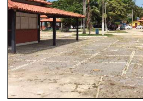
Foto 05 - Danos existentes na calçada em Pedra Portuguesa.
