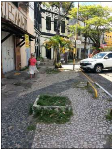
Foto 05 - Calçadas da Av. Dois de Julho. Necessidade de restauração, possibilitando a acessibilidade.
