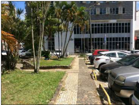
Foto 08 - Calçadas de uma das "ilhas" da Av. Dois de Julho. Necessidade de restauração, possibilitando a acessibilidade.
