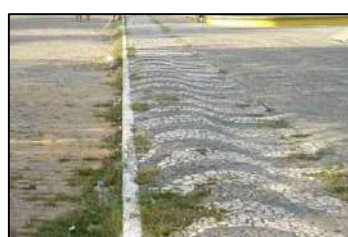
Foto 01 - Calçadas com pedra portuguesa com vários pontos com onde faltam pedras ou com crescimento de vegetação.
