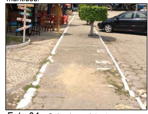
Foto 04 - Calçadas existentes no acesso à praia a serem refeitas.
