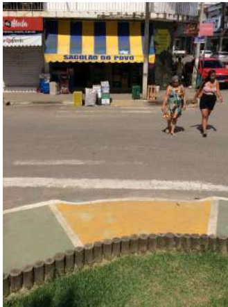
Foto 05- Má execução de elementos referente à acessibilidade.
