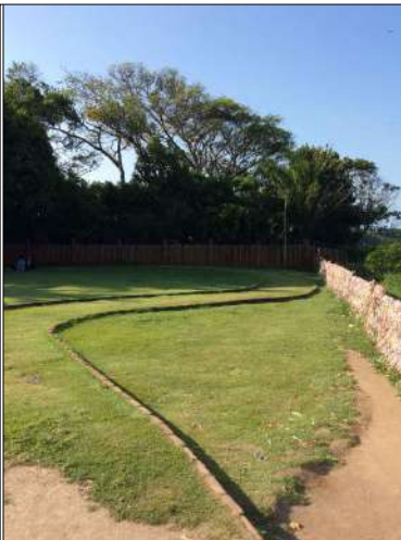
Foto 05 - Vista do passeio existente com crescimento de grama que gera obstáculo ao transeunte.
