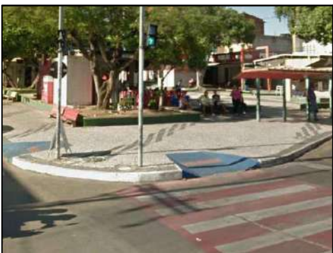
Foto 04 - Rebaixamentos de calçadas existentes a serem refeitos conforme NBR-9050.
