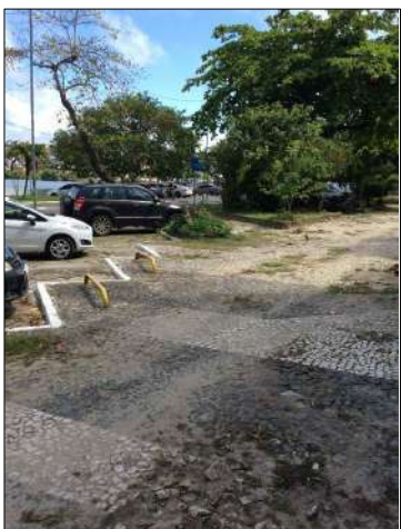
Foto 15 - Av. Dois de Julho apresentando necessidade de intervenção nas calçadas.
