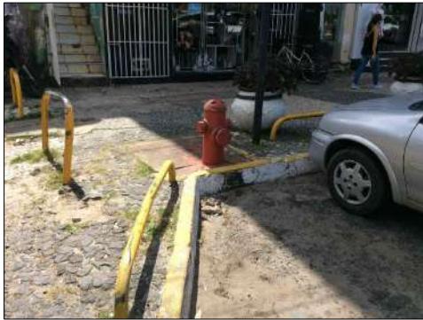
Foto 04 - Calçadas da Av. Dois de Julho. Necessidade de restauração, possibilitando a acessibilidade.
