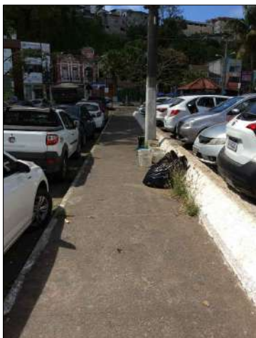
Foto 10 - Calçadas da Av. Cel. Misael Tavares. Necessidade de restauração, possibilitando a acessibilidade.
