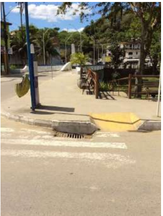
Foto 04- Faixas existentes em más condições.
