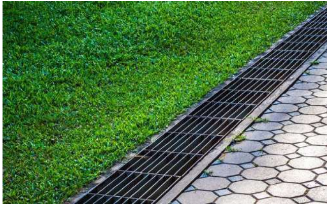
Imagem 4: Utilização de grelhas para águas pluviais
