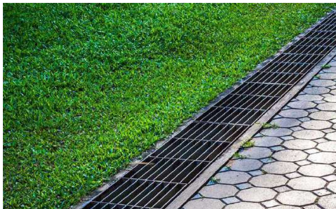
Imagem 4: Utilização de grelhas para águas pluviais
